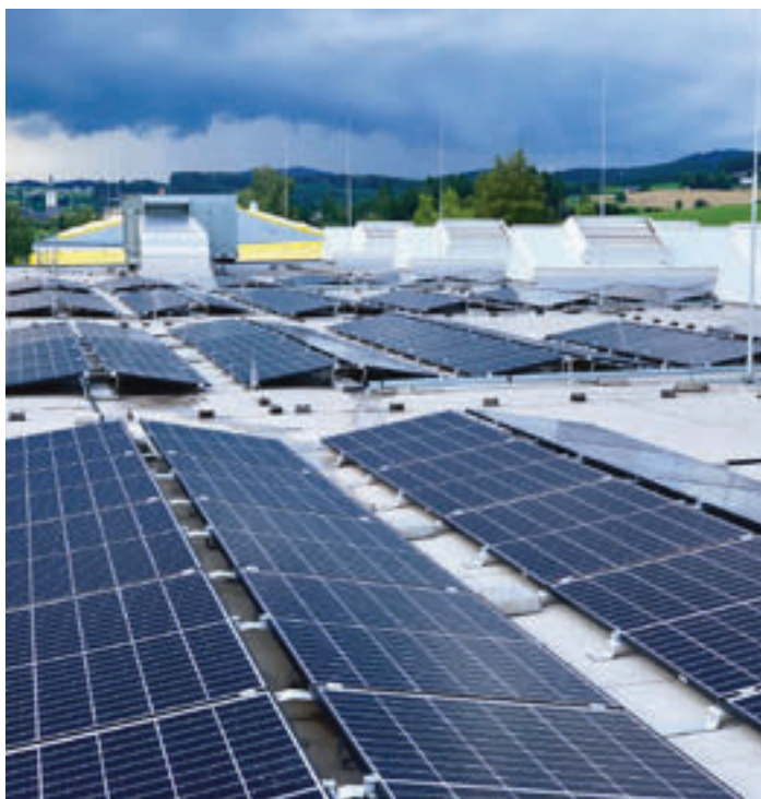
Seit Juli 2020 ist die eigene Photovoltaik-Anlage, die 200 kWp umfasst, bei HappyFoto in Betrieb. Sie wurde am Dach des Firmengebäudes im Zuge eines Energie-Contracting-Projektes mit der Energie AG installiert und produziert jedes Jahr rund 200.000 Kilowattstunden Sonnenstrom.
